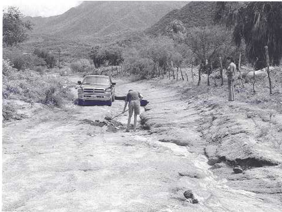
Immer wieder ist die Straße weggespült
